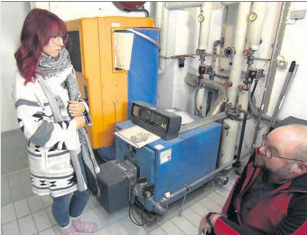
Ist die alte Heizungsanlage kaputtgegangen, kann eine mobile Heizzentrale während der Überbrückungszeit Wärme bereitstellen. Foto: djd-k/Hotmobil
