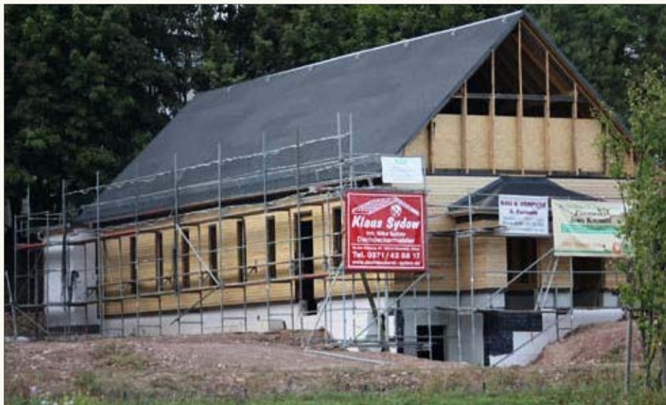
Der Wiederaufbau der Kirche an ihrem neuen Standort an der Zwickauer Straße geht stetig voran. Am 15. April 2013 soll die Eröffnung stattfinden. Foto: Zscheile
