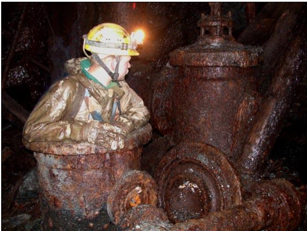
Und hier sieht man hintereinander den Steuer- und den Arbeitszylinder auf der Stollensohle. Um die Dimension der Anlage sichtbar zu machen, "posted" ein "Model" einmal mitten im Arbeitszylinder. Der Deckel übrigens war schon ab und von der Traverse ist leider auch nichts mehr übrig... (Foto: Steve Müller)
