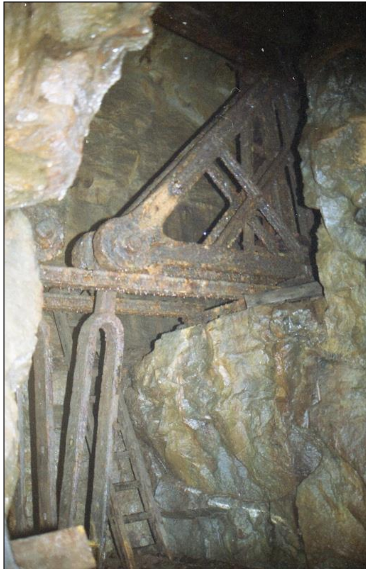
Diese Anlage ist technisch nämlich besonders anspruchsvoll, waren doch hier gleich zwei Räder (ein Kehr- rad und ein Kunstrad) untertage eingebaut. Im Bild die eisernen Kunstwinkel zum Antrieb der Pumpenge- stänge.
